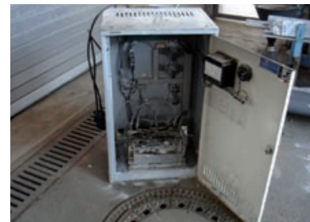
Bild 7-7: Durch Brandschaden zerstörtes Batterieladegerät
