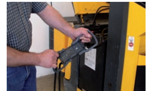
Bild 7-3: Kontaktierung einer eingebauten Flurförderzeugbatterie mit dem Ladegerät mittels berührungssicherer Steckvorrichtung
