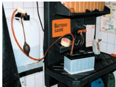
Bild 7-5: Säure-Nachfüllplatz einer Batterieladestation
