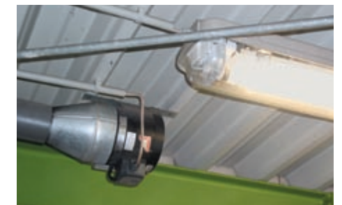
Bild 3-7: Technische Lüftung mit Sauglüfter und Deckenleuchte in Ex-Schutz
