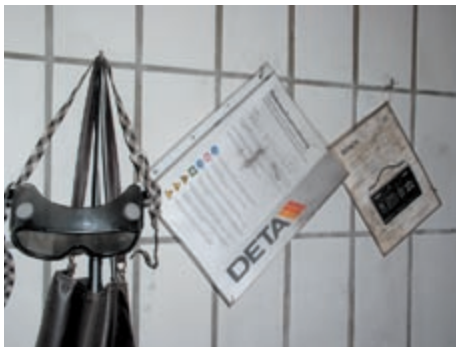
Bild 7-1: In einer Batterieladestation ausgehängte Gebrauchs- und Bedienungsanleitung
