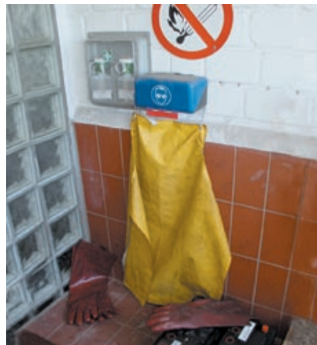
Bild 7-6: Bereitgestellte PSA in einer Batterieladestation
